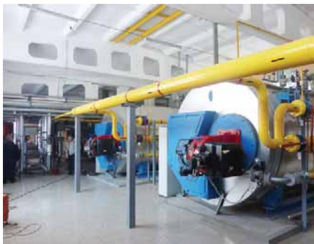
Котельная ОАО «Горынский агрокомбинат»
