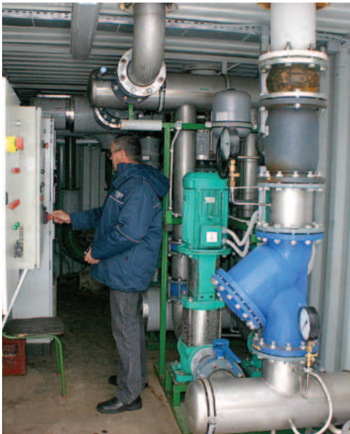
Обслуживание блочно-модульного ЦТП
