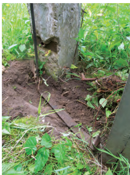
Рис. 3. Разрушение сварного соединения на шинном разъединителе ТСН-1
