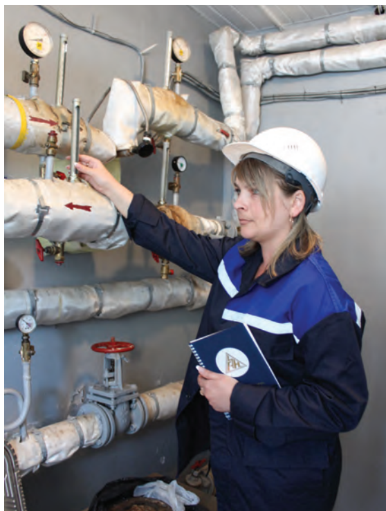
Государственный инспектор Гомельского МРО Ю.Н. Леонова проверяет готовность теплового пункта к ОЗП
