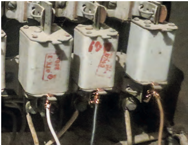
Рис. 3. Отсутствие наконечников многопроволочных кабелей
