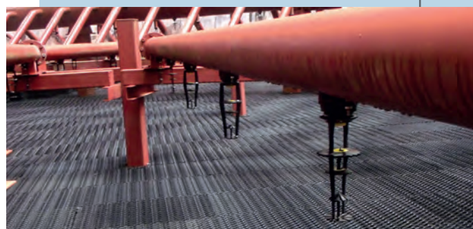
Рис. 5. Оросительное и водораспределительное устройства старой (вверху) и новой конструкции
