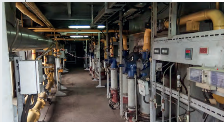
Технологическое помещение котельной
