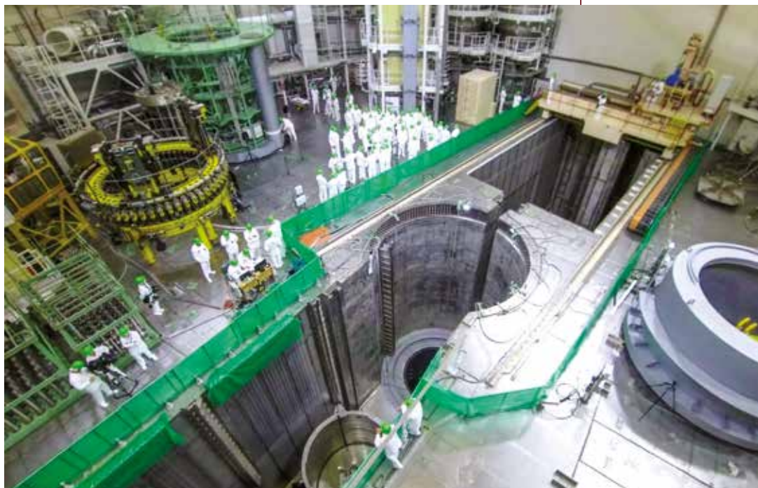
Здание реактора № 1 Белорусской АЭС. Последние минуты перед началом загрузки топлива
