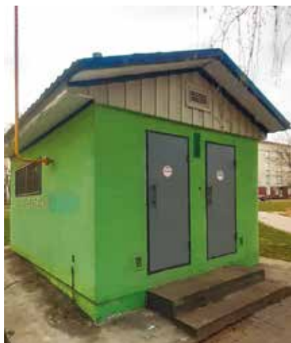
Рис. 2. Общий вид газорегуляторного пункта
