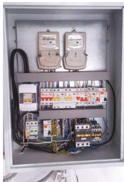
Рис. 4. Шкаф учета электрической энергии
