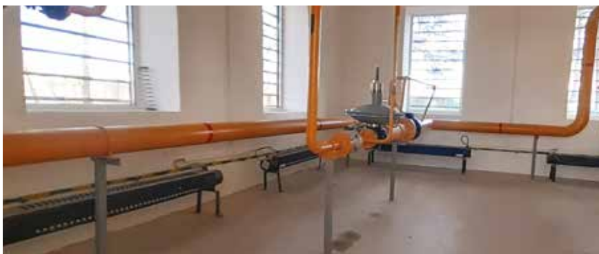
Рис. 1. Технологическое помещение ГРП с установленными взрывозащищенными электроконвекторами ОВЭ-4
