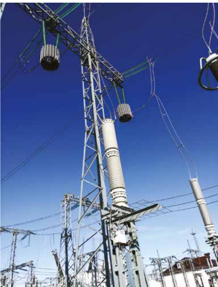
Оборудование ВЧС (корзина ВЧ-заградителя, высоковольтный конденсатор связи, фильтр присоединения) ВЛ № 343 на ПС 330 кВ «Минск Северная»
