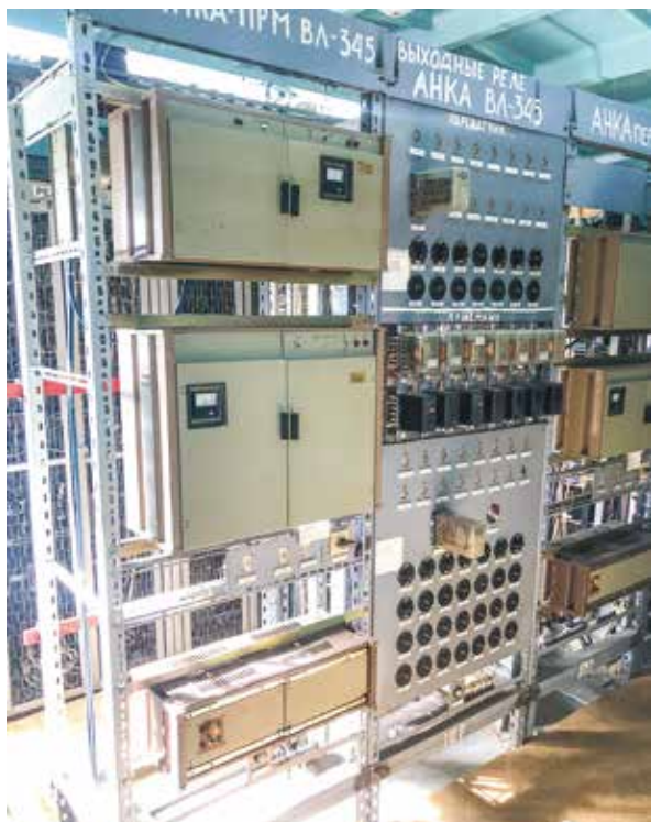
Шкафы приемопередатчиков ВЧС типа АНКА и их выходные реле ВЛ № 345 на ПС 330 кВ «Полоцк»
