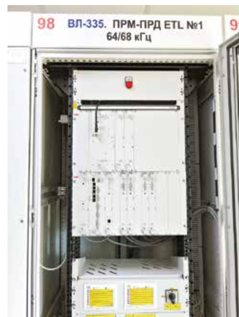
Шкаф приемопередатчика типа ЕТЛ 600 ВЛ № 335 на ПС 330 кВ «Минск Северная»
