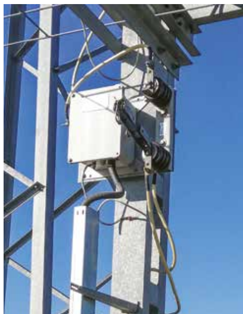
Фильтр присоединения (элемент ВЧС) ВЛ № 343 на ПС 330 кВ «Минск Северная»
