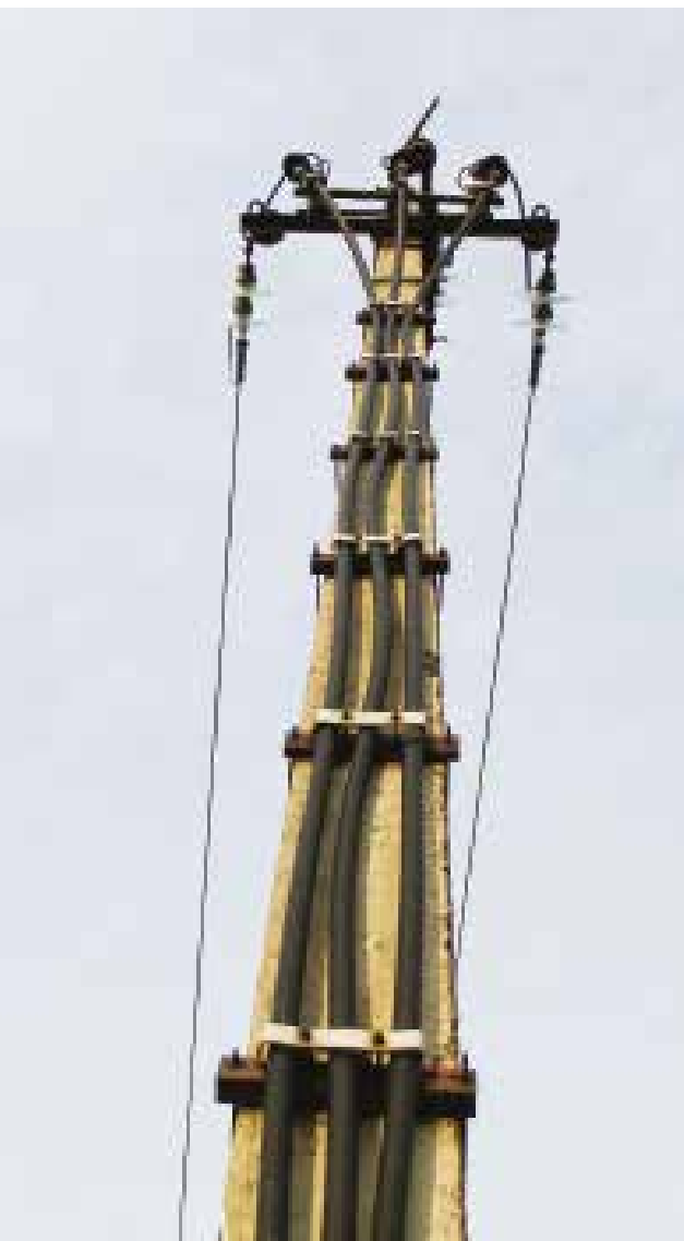
Вертикальный участок КЛ с СПЭ-изоляцией
