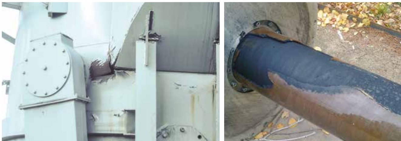
Рис. 3. Повреждение бака трансформатора и высоковольтного ввода изоляции электрической дугой
