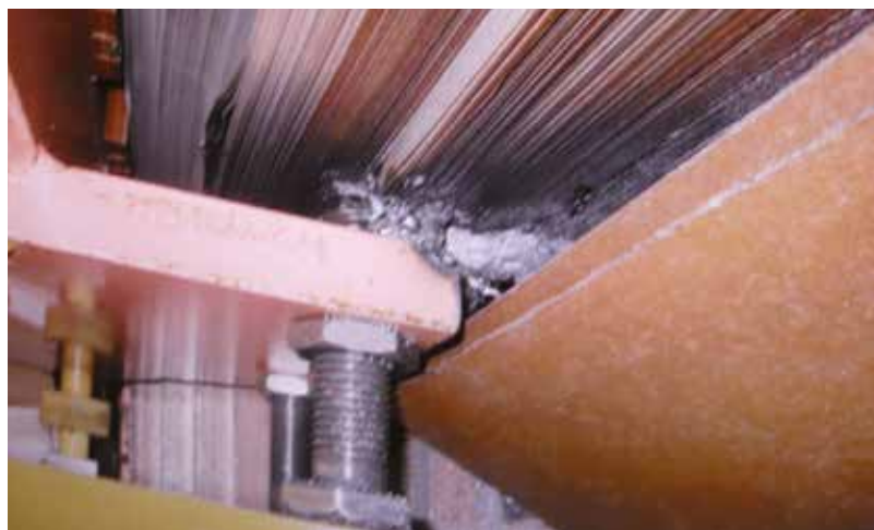
Рис. 2. Оплавление стяжной шпильки маслонаполненного трансформатора в результате электродуговой сварки металла
