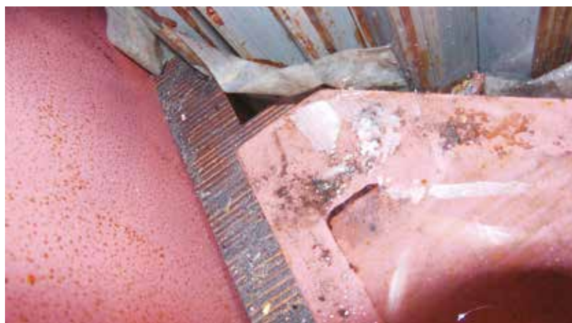
Рис. 2. Загрязнение узлов трансформатора механическими примесями, которые вызвали ЧР величиной более 1000 пКл
