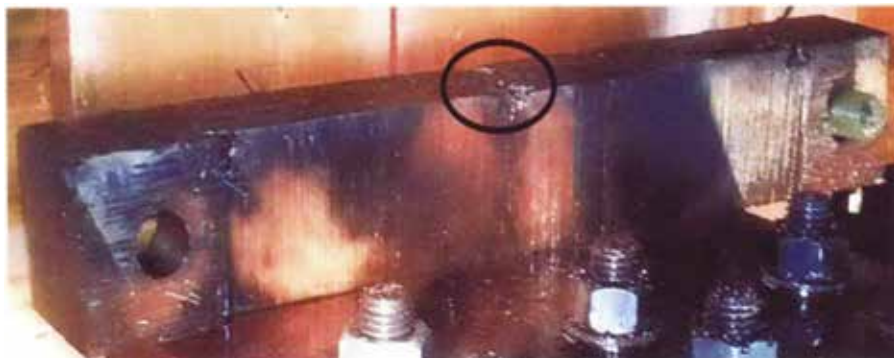
Рис. 3. Результат воздействия электрической дуги на узлы трансформатора
