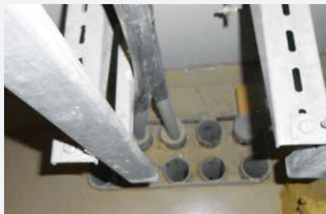
Трубная проходка кабельной линии через стену помещения
