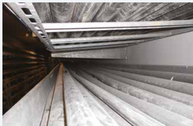
Силовые кабели, уложенные в лотках
