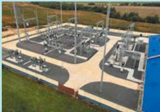
Рис. 3. ПС 110 кВ «Аульс»
