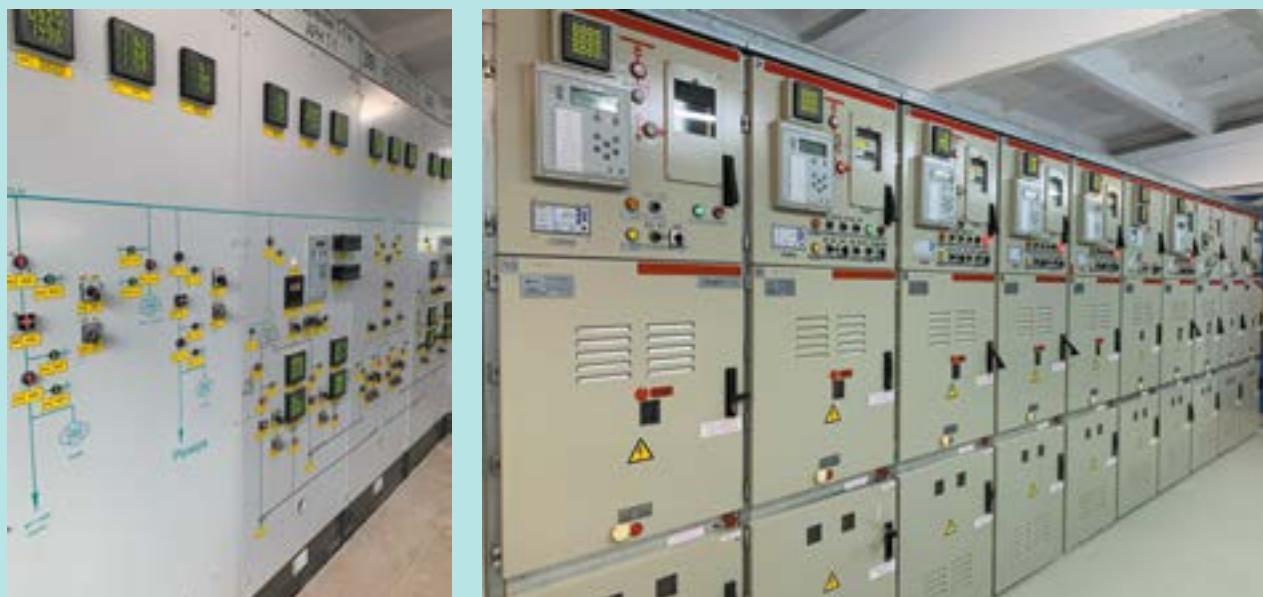
Рис. 2. Отечественные микропроцессорные устройства РЗА на объектах ГПО «Белэнерго»
