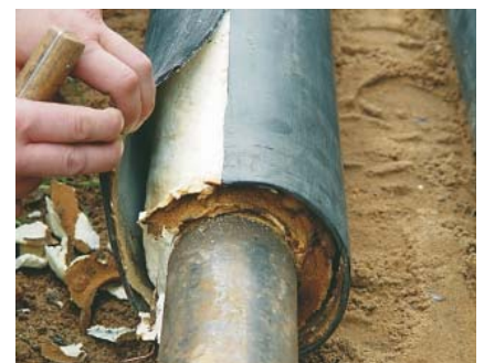
Брак ПИ-трубы (отслоение трубы-оболочки от ППУ изоляции)
