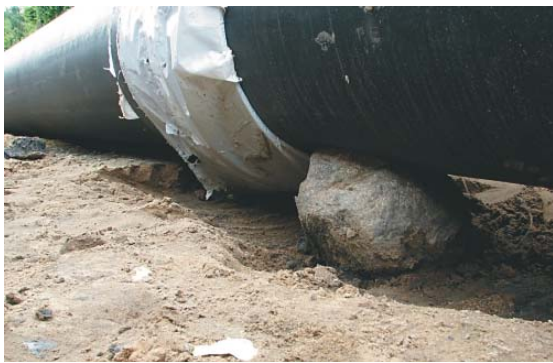
Некачественный монтаж ПИ-трубопровода
