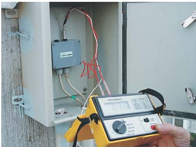
Проверка состояния теплоизоляционного слоя ПИ-трубопровода посредством системы оперативно-дистанционного контроля
