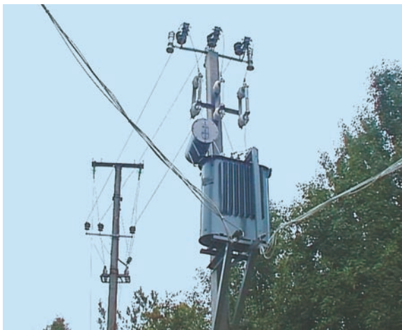
СТП 10 кВ, смонтированная на специальной железобетонной стойке
