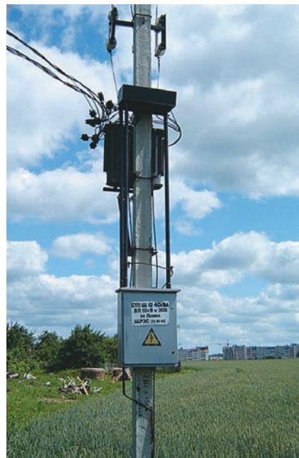
СТП 10 кВ, смонтированная на типовой железобетонной стойке
