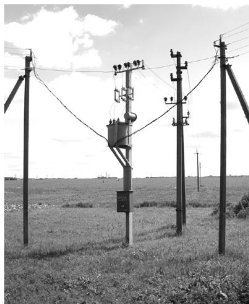
Электросеть 0,4–10 кВ (СТП – ВЛИ)
