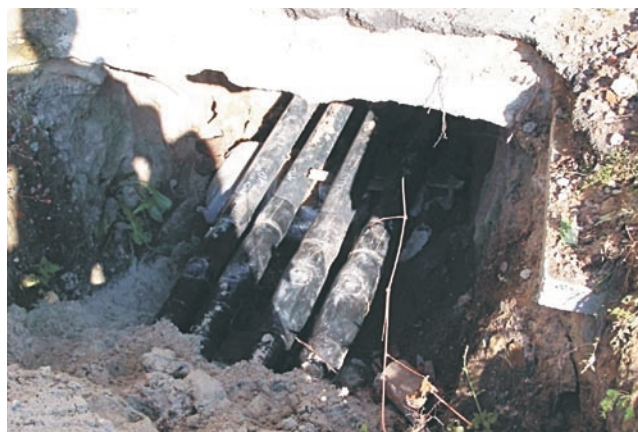
Теплотрасса к жилому дому проложена с нарушением технологии монтажа ПИ-труб: отсутствует песчаная подушка под ПИ-трубу
