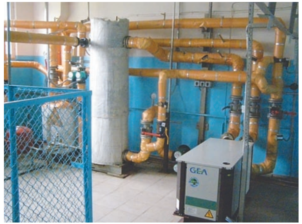
Установка для утилизации тепла автотрансформатора
