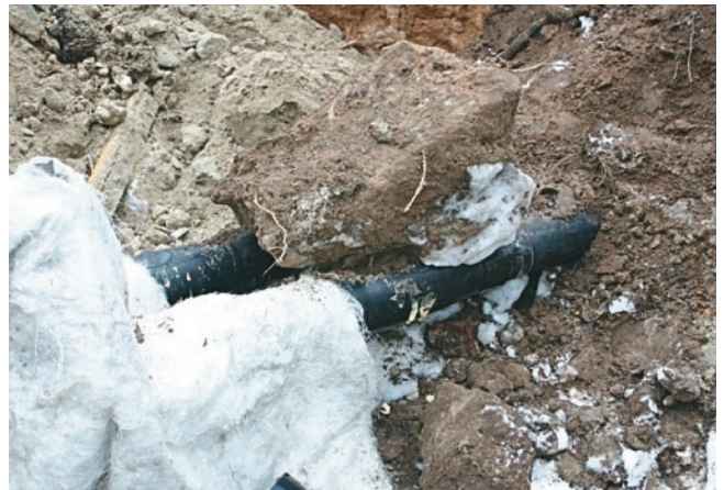
Рис. 2. Нарушение при обратной засыпке
