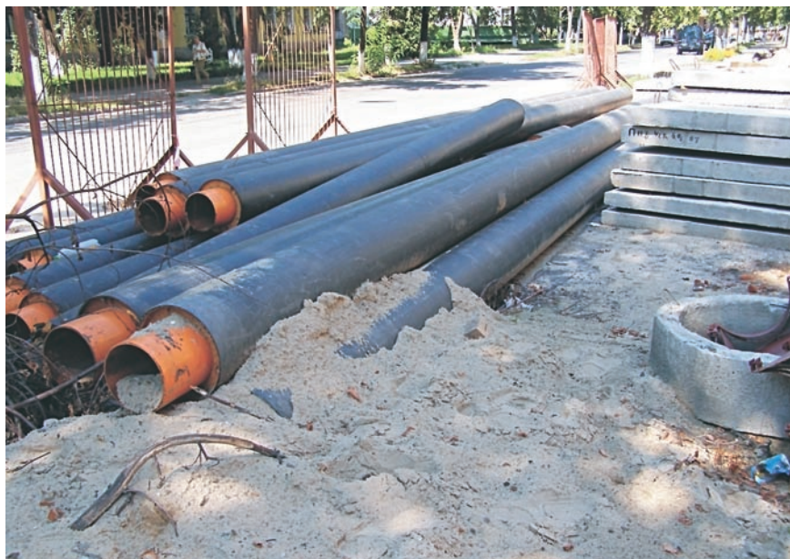
Складирование ПИ-труб с нарушениями требований ТНПА
