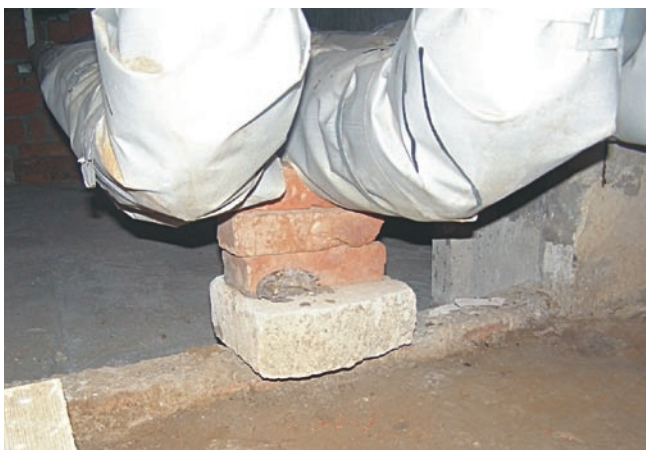
Опора трубопроводов выполнена из кирпичей в нарушение ТНПА
