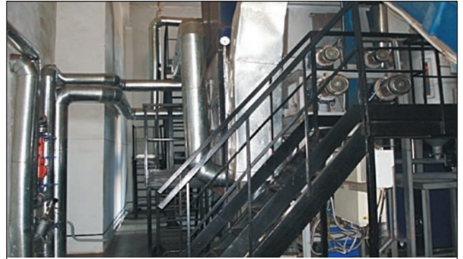
Рис. 2. Автоматизированная котельная установка с водогрейным котлом с топкой кипящего слоя на фрезерном торфе тепловой мощностью 3 МВт
