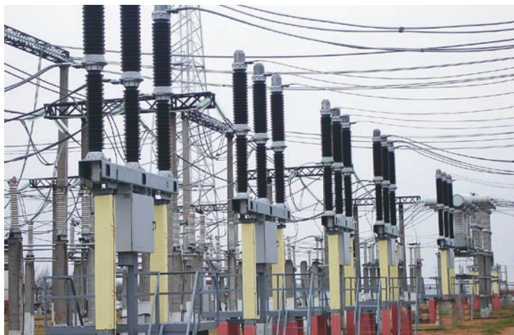
Подстанция 330 кВ «Кричев», ОРУ 110 кВ
