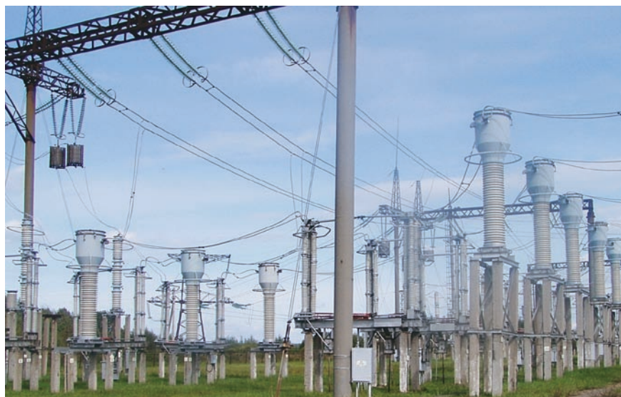
Подстанция 330 кВ «Кричев», ОРУ 330 кВ
