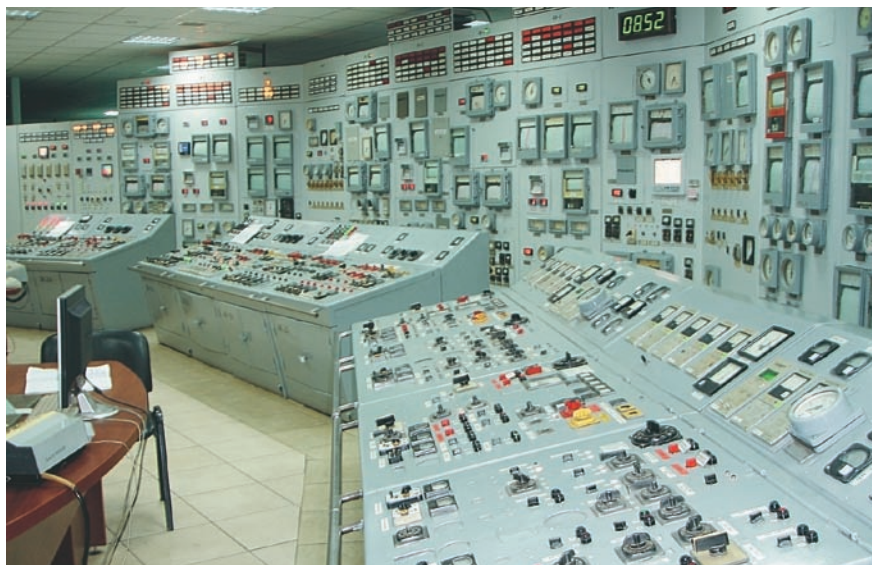
Центральный тепловой щит № 1
