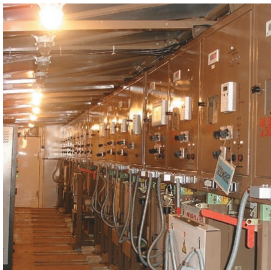
Подстанция 35 кВ «Хотимск», КРУН-10
