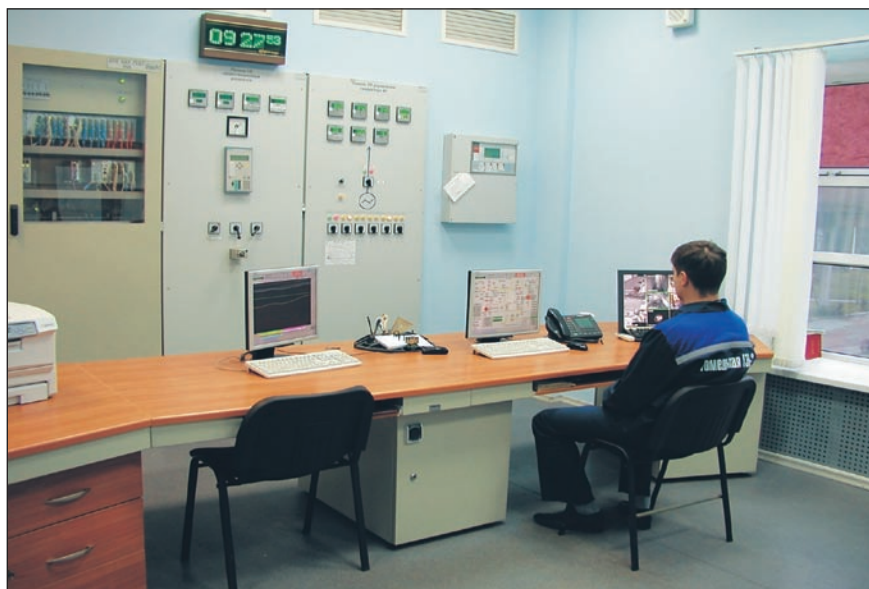
Рис. 5. Щит управления УТДУ
