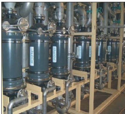
Рис. 5. Установка мембранной дегазации
