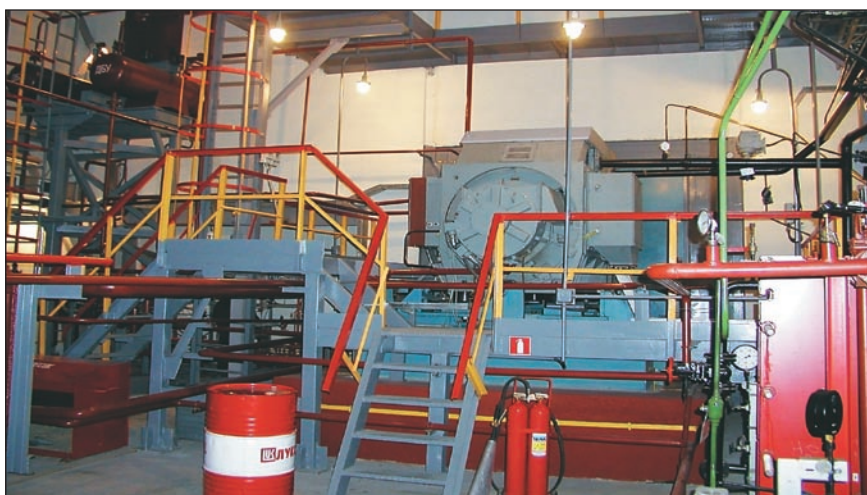
Рис. 4. Помещение генераторного отделения
