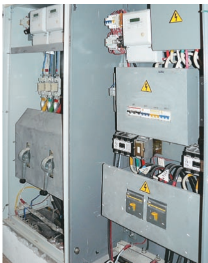
Вводно-распределительное устройство с АВР доильного блока МТФ ОАО «Рудаково»
