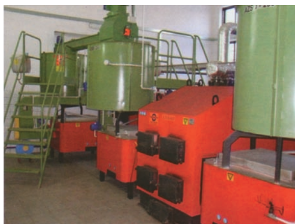
Котельный комплекс 2000 кВт (на базе котла KWH-2000 и двух систем AZSD-1000)
