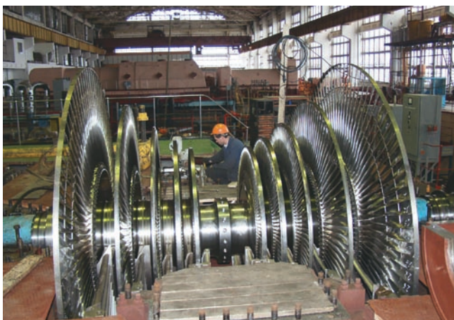
Модернизированный ротор цилиндра низкого давления турбины К-300-240-1 ЛМЗ Лукомльской ГРЭС
