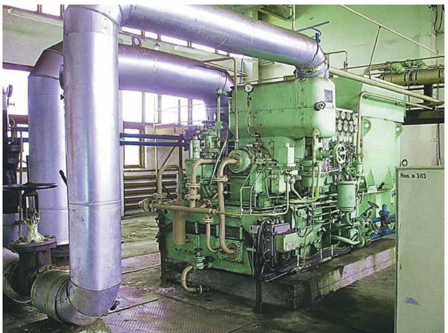
Турбогенератор «Кубань-06С» в котельной торфобрикетного завода «Дитва»
