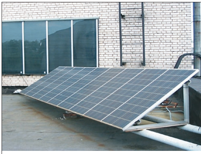
Рис. 2. Солнечный тепловой коллектор и солнечные фотоэлектрические модули
