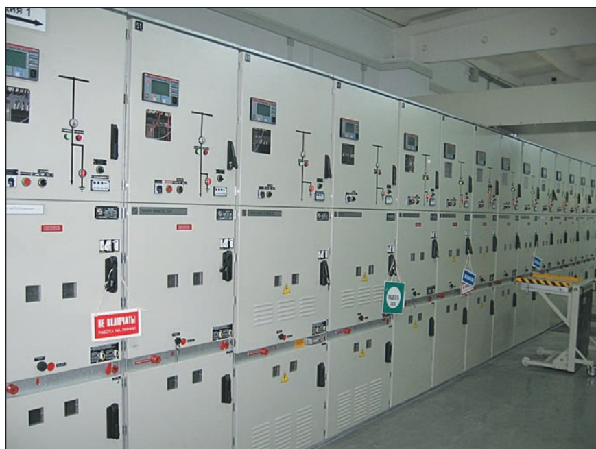
Закрытое распредустройство 6 кВ
