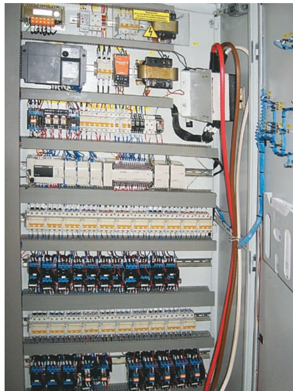
Пульт управления зерносушильного комплекса КЗСВ-30
