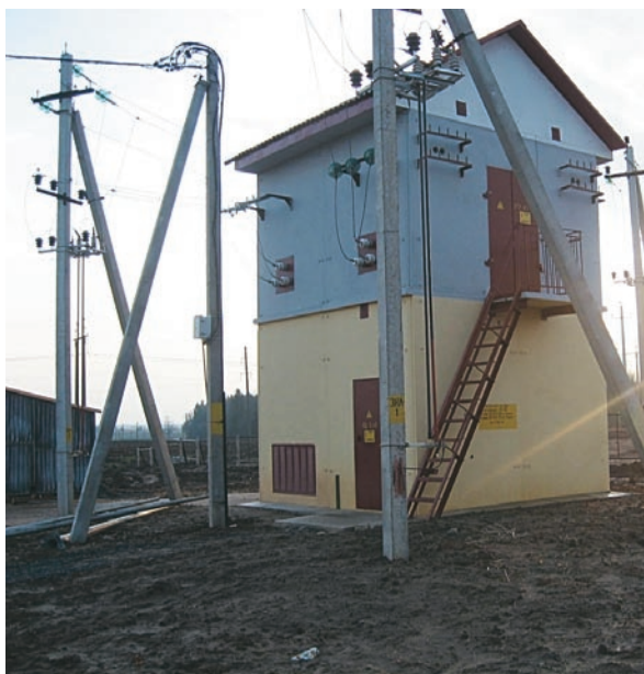
Трансформаторная подстанция МТФ «Шепелево» СПФ «Мнюто» ОАО «Глубокский МКК»
