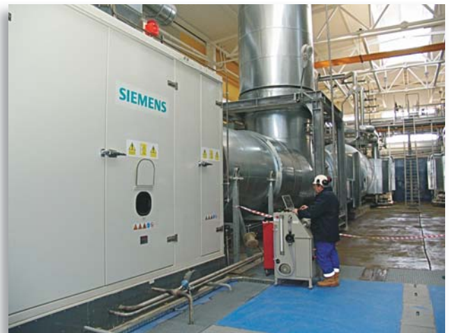
Газотурбинная установка Siemens SGT-300 на ОАО «Гродно Азот»
