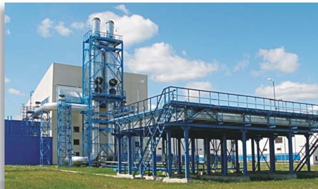
Когенерационная электростанция Wärtsilä на РПУП «Шкловский завод газетной бумаги»
