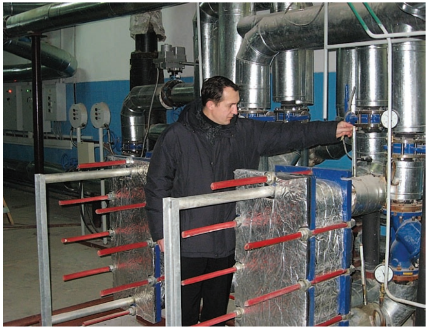
Проверка теплового пункта РУП «Витязь»
