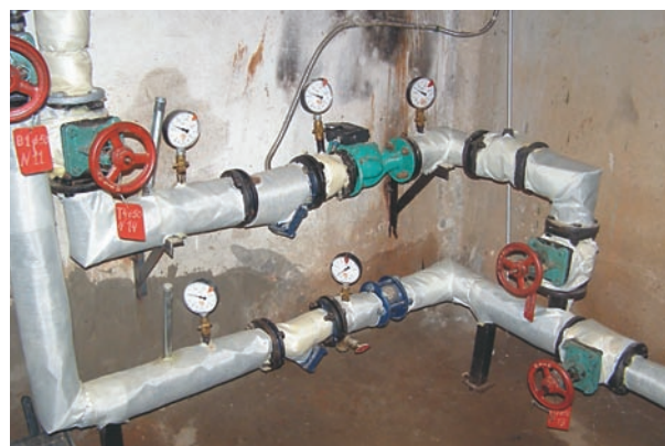
Тепловая изоляция трубопроводов ГВС УО «ГПТУ-35 им. М.Ц. Лынькова»
