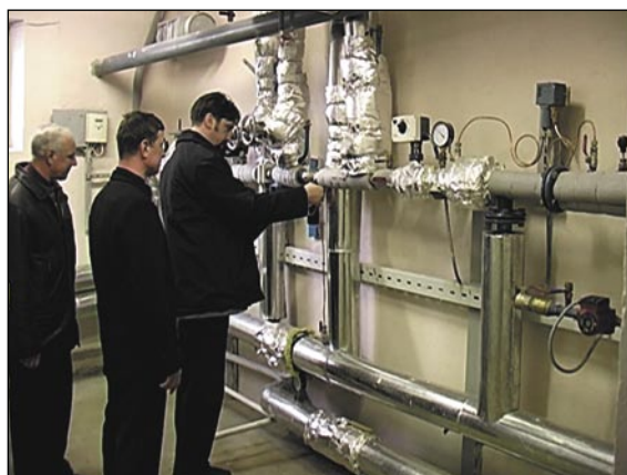
Рис. 3. В тепловом пункте больницы скорой помощи г. Бреста работает комиссия по проверке готовности к ОЗП
