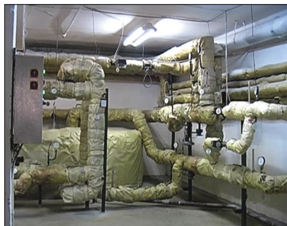
Рис. 4. Тепловой пункт спорткомплекса «Виктория» (г. Брест)
