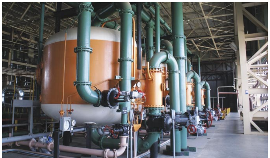
Обессоливающие установки энергоблока № 1
