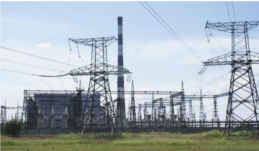
Открытое распределительное устройство 330 кВ
