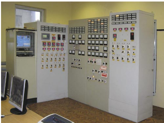
Щитовая мини-ТЭЦ, ОАО «Мостовдрев»
