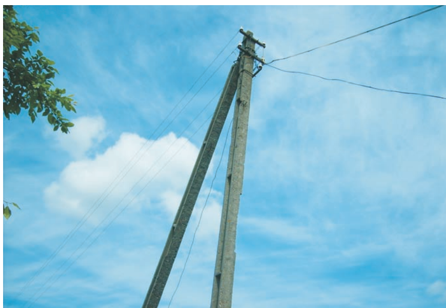
Аварийное состояние железобетонной опоры 0,4 кВ (скол)
