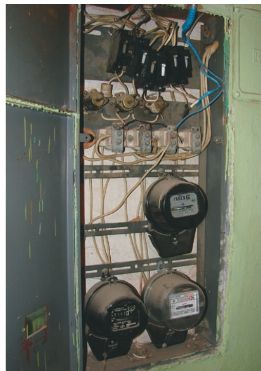
Аварийное состояние этажного электрощита в жилом доме
