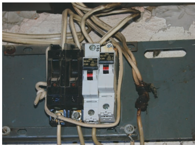
Вводное устройство в аварийном состоянии
