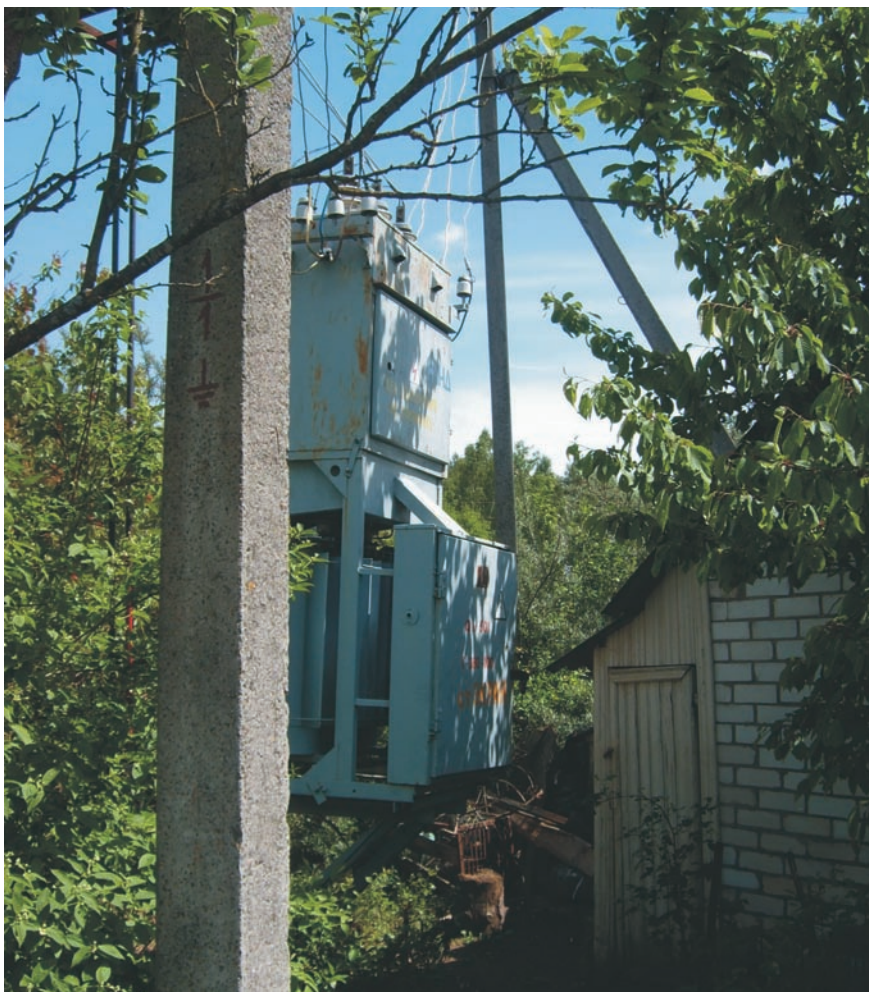
Нарушен пункт 11 «Правил охраны электрических сетей напряжением свыше 1000 В», а также условие пожарной безопасности согласно ПУЭ п.5.1.132, которое предусматривает, что расстояние от подстанции до ближайшего сооружения должно быть не менее 3 м
