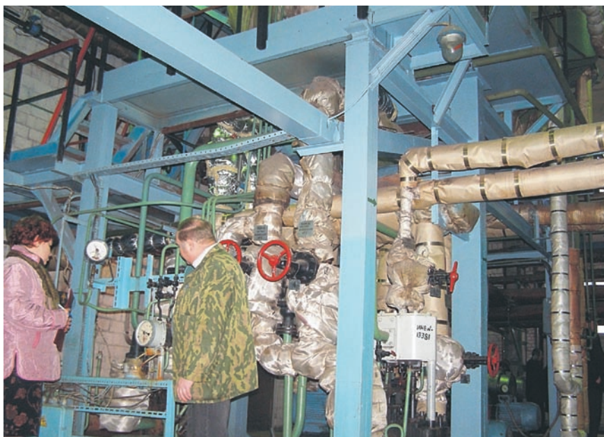
Комиссия проверяет готовность теплоисточника ОАО «8 Марта»
