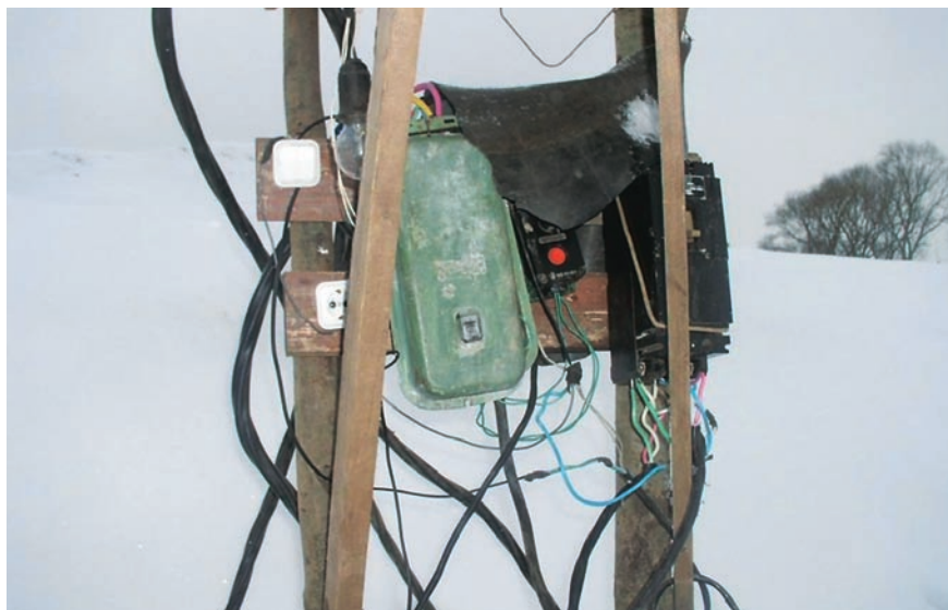
Неправильный монтаж вводного устройства на стройплощадке
