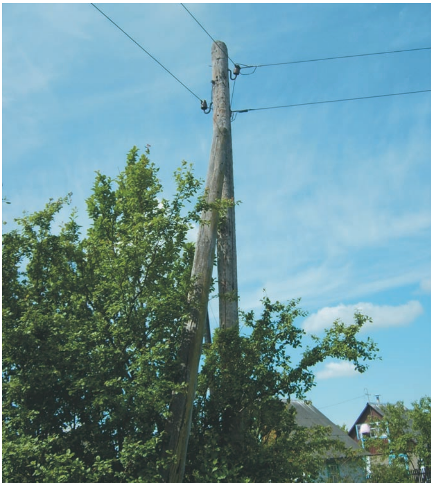
Опора изъедена насекомыми в связи с отсутствием пропитки древесины антисептиками (ПУЭ п.2.4.32)
