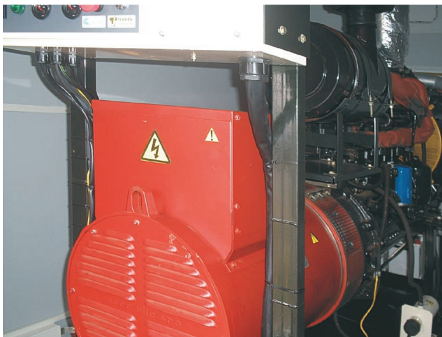
Дизель-генератор ДГ-60 (АД 48С-Т400-2РП) мощностью 48 кВт установлен в качестве резервного источника электроснабжения хирургического и акушерского корпусов в УЗ «Рогачевская ЦРБ»
