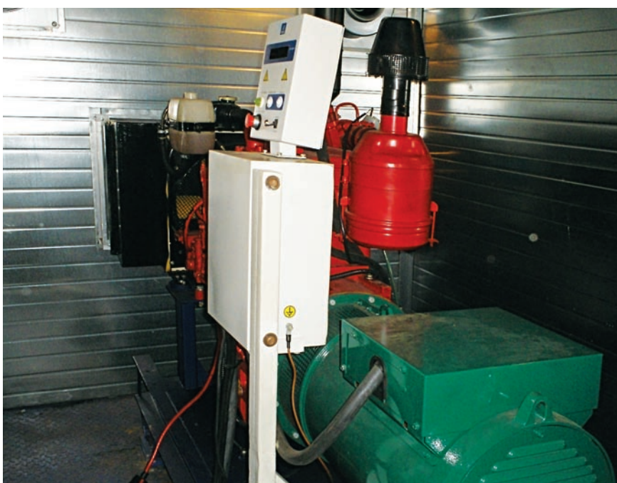
Дизельный генератор ДГ-60 (АД 48С-Т400-2РП) мощностью 48 кВт, обеспечивающий резервное электроснабжение роддома УЗ «Жлобинская ЦРБ»
