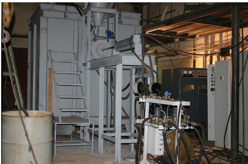
Рис. 3. Установка по подготовке к захоронению зараженной радионуклеидами золы мини-ТЭЦ
