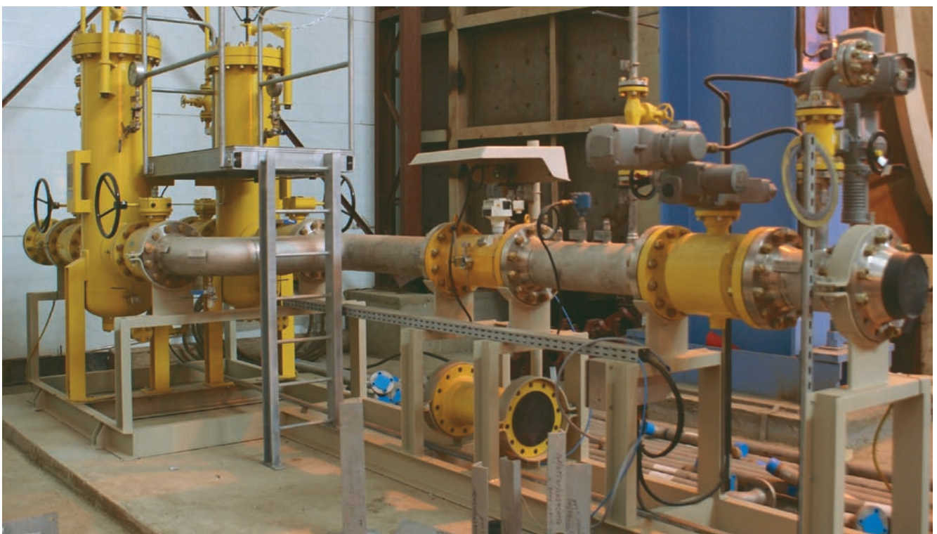
Узел газовой турбины ПГУ-230
