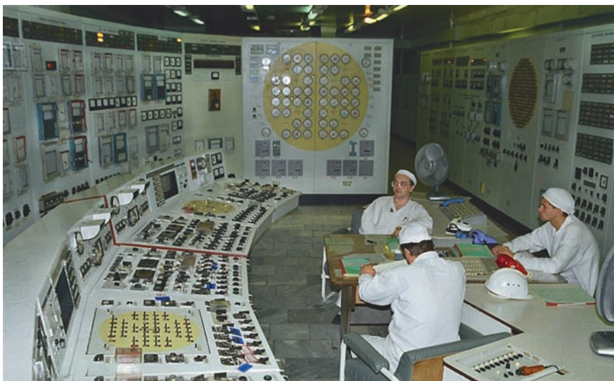
Билибинская АЭС, центр управления
