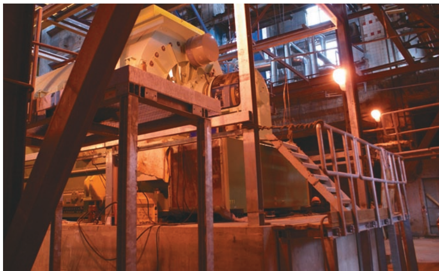
Вид газовой турбины ПГУ-230
