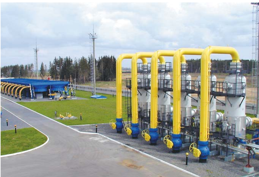
Компрессорная станция «Несвижская»
