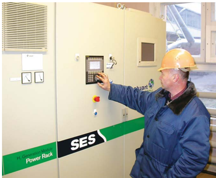
Новое оборудование электролизерной (бельгийская установка по производству водорода)
