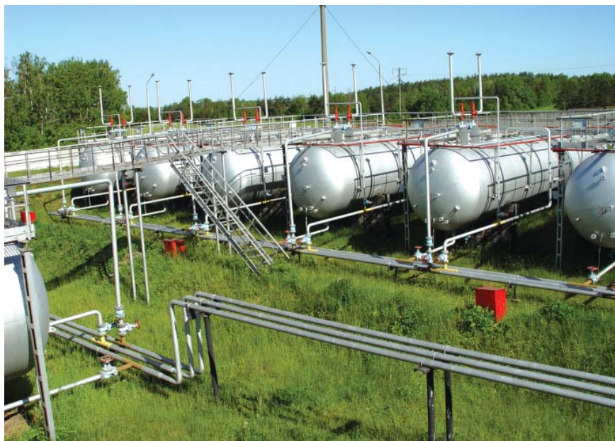
Резервуарный парк Гродненской газонаполнительной станции
