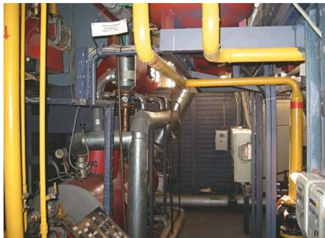
Блочно-модульная котельная «Грушевская»
