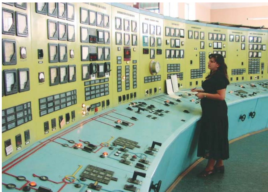
Главный щит ТЭЦ
