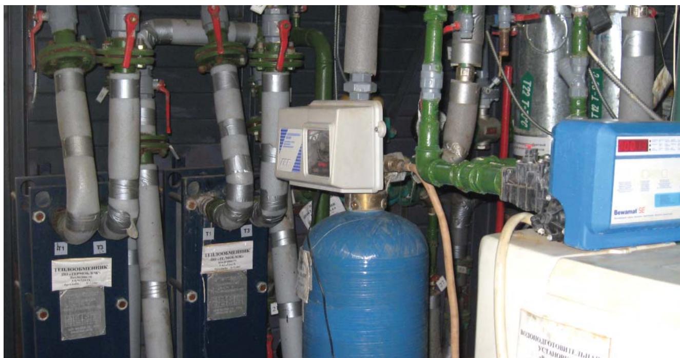
Тепловой узел котельной
