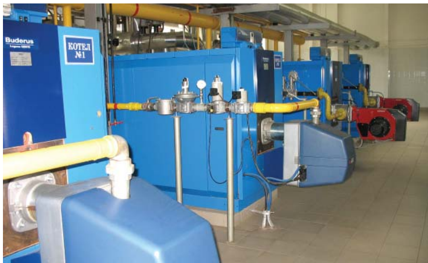
Котельная санатория «Озерный» РУП «Гродноэнерго»
