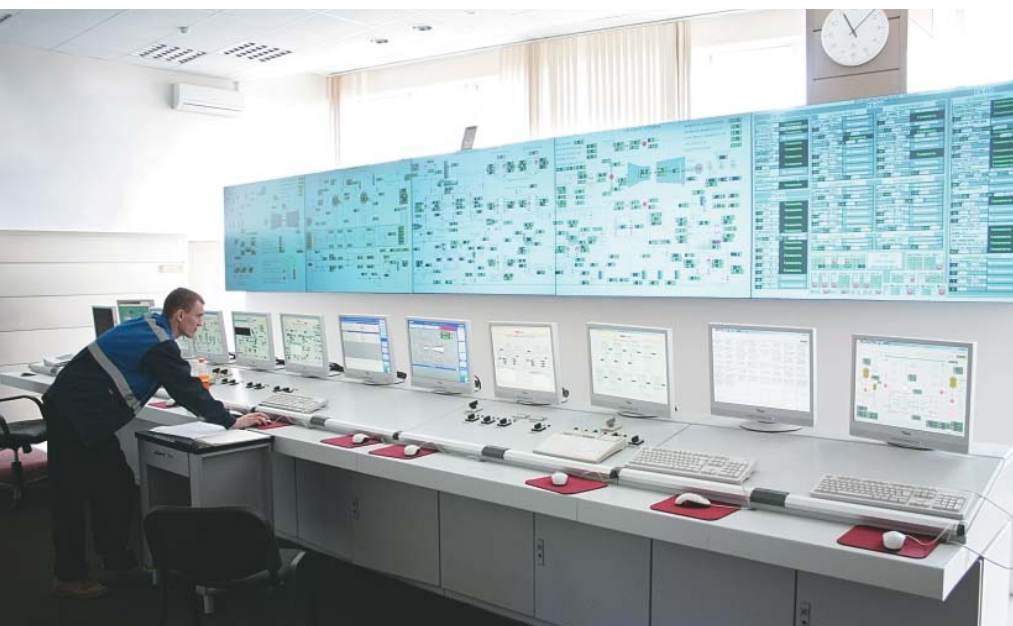
Щит управления ПГУ-230
