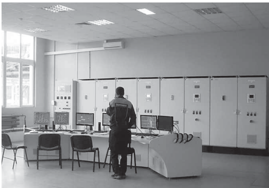
РУ 6 кВ ГПП-1-110/6 кВ после реконструкции
