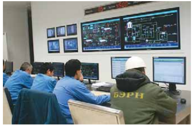
Центральный щит управления
