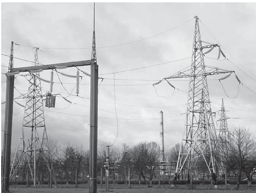
ВЛ 110 кВ ПС-330 «Полоцк» – ГПП-1 и ПС «Районная» – ГПП-1
