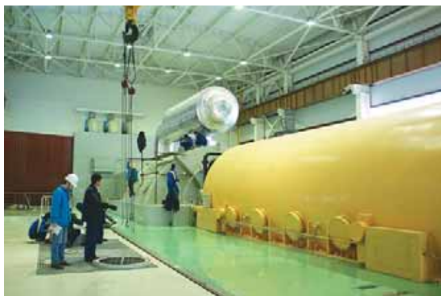
Машинный зал энергоблока № 2 Минской ТЭЦ-5
