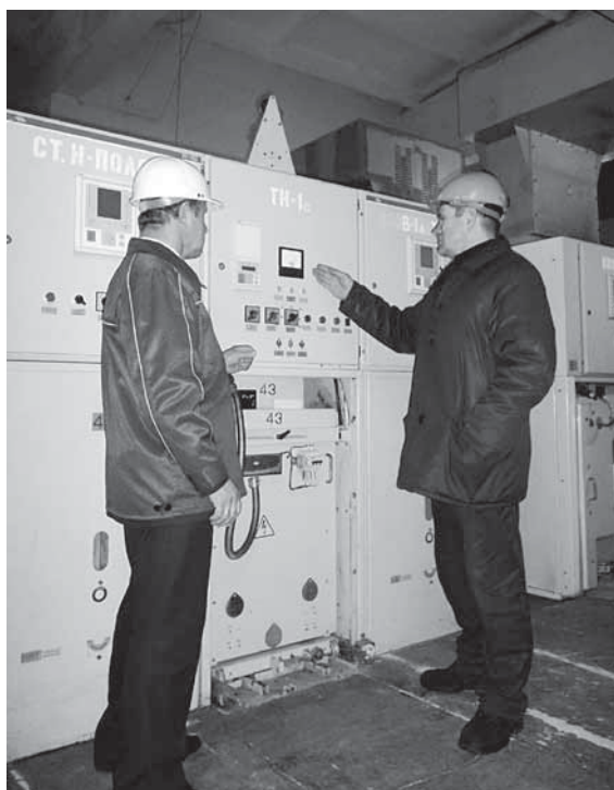
РУ 6 кВ ГПП-1-110/6 кВ после реконструкции
