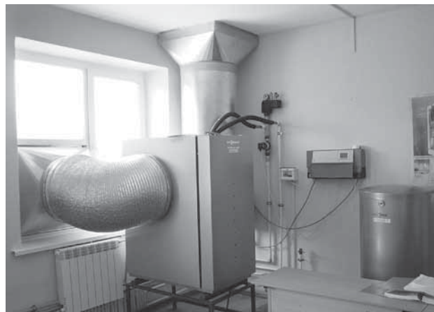
Тепловой насос, установленный на демонстрационной базе БГАТУ
