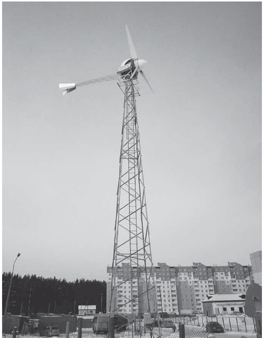
ВЭУ мощностью 7,5 кВт, установленная на демонстрационной базе БГАТУ
