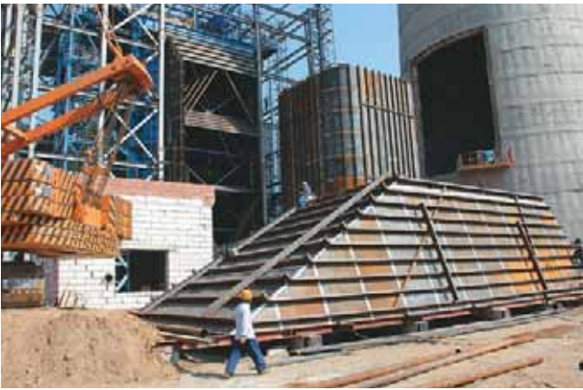
Подвод газохода к дымовой трубе
