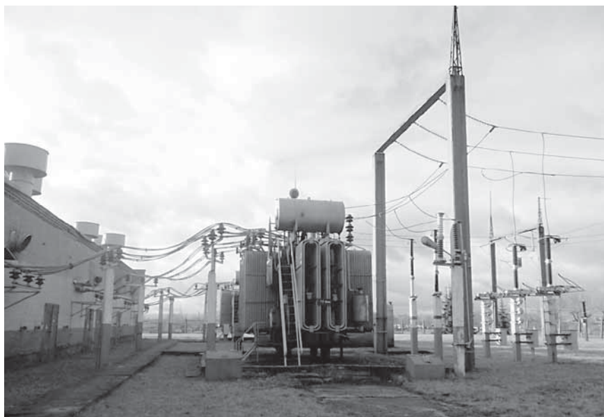
ОРУ 110 кВ и силовые трансформаторы Т-1, Т-2 (63 МВА) ГПП-1-110/6 кВ
