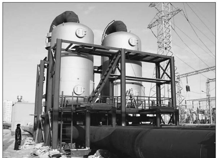
Рис. 7. Грязевики ГИГ-6000 ВК на Приморской котельной. Установлены в 2009 году
