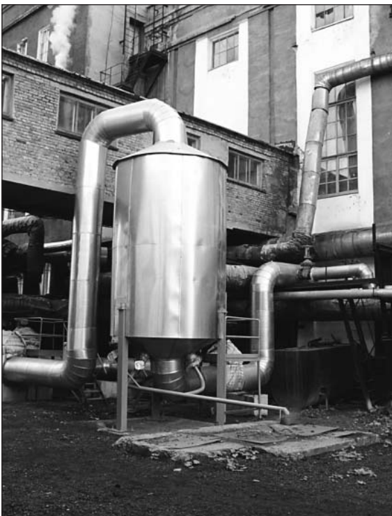
Рис. 6. Грязевик ГИГ-2300 на Интинской ТЭЦ ОАО «ТГК-9». Установлен в 2007 году
