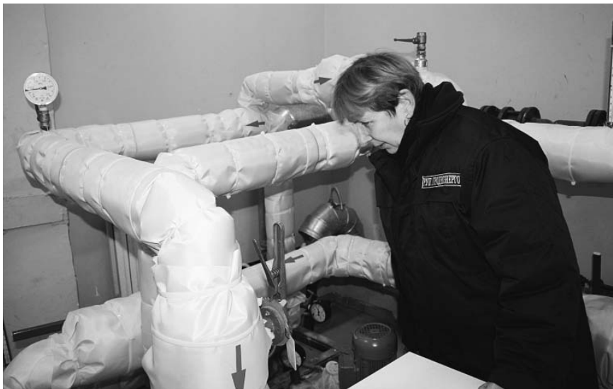
Тепловой пункт административного здания подстанции
