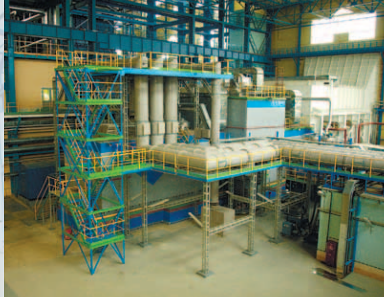
Общий вид ГТУ 121,7 МВт
