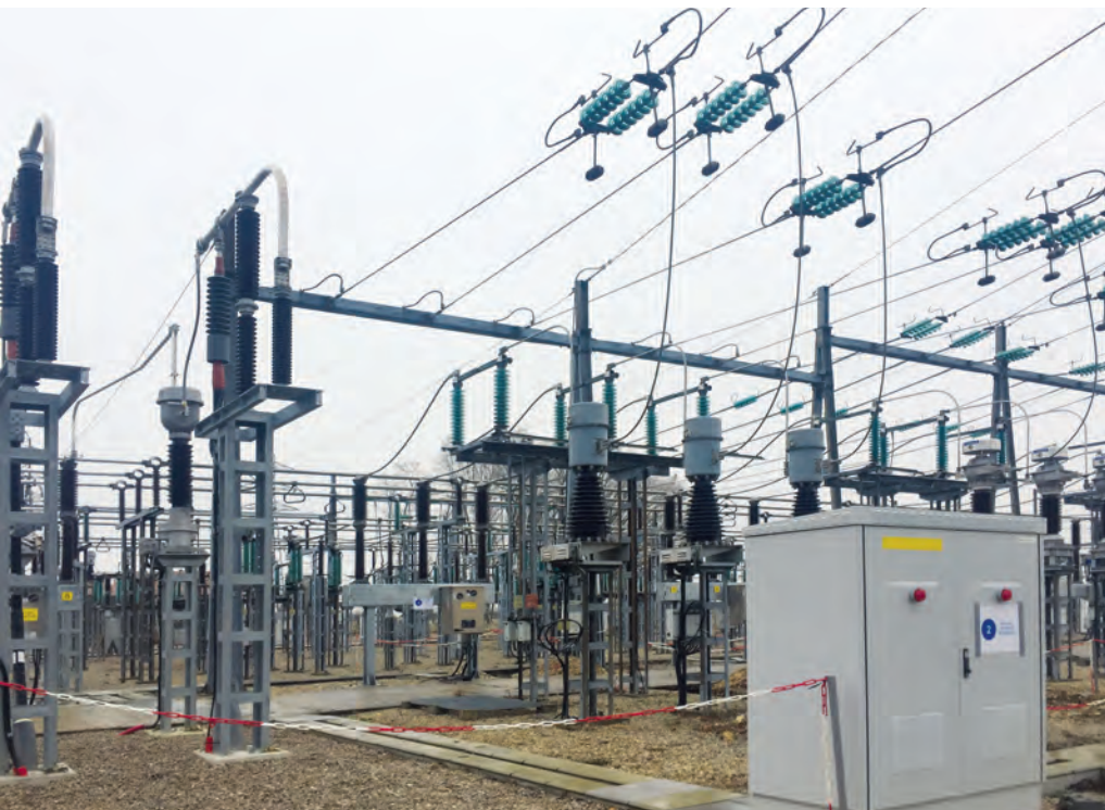
ОРУ 90 кВ на подстанции 225/90/20 кВ «Блоко» (Блоках)
