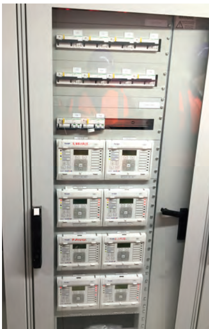
Шкаф РЗА на подстанции 225/90/20 кВ «Блоко» (Влюсах)
