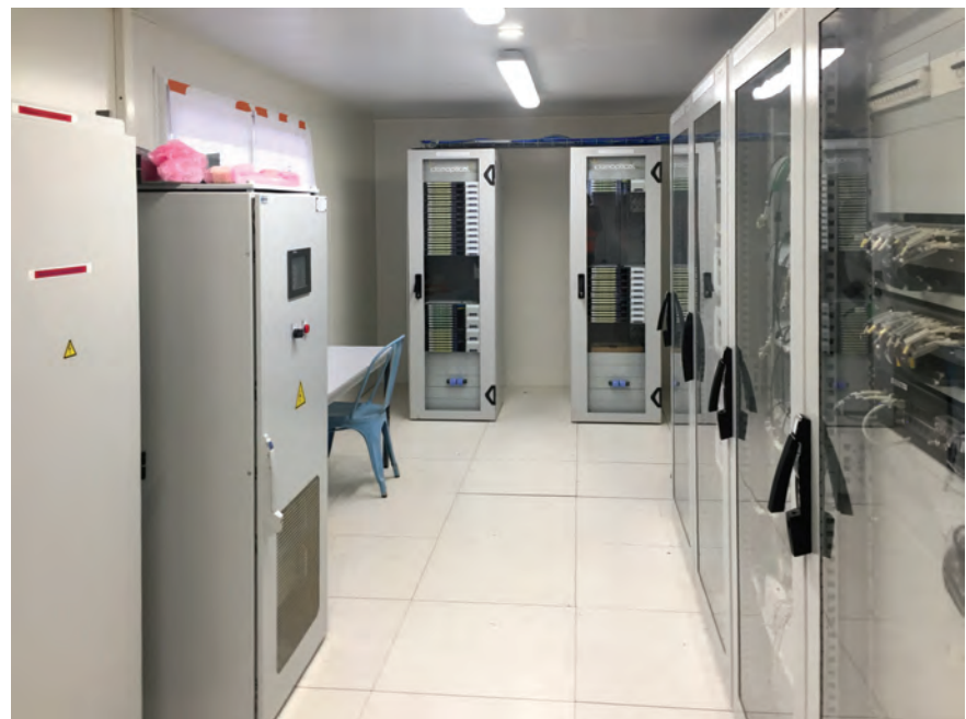
Оперативный пункт управления подстанции 225/90/20 кВ «Блоко» (Влюсах)
