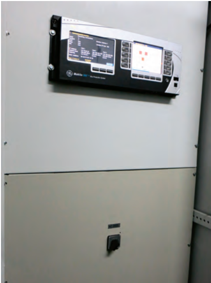
Шкаф первого комплекса дифференциальной защиты шин 110 кВ на ПС 110 кВ «Приречная»
