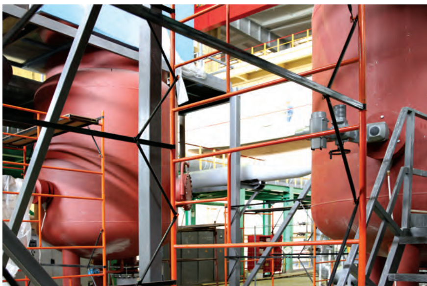
Электрокотельная установка Гомельской ТЭЦ-2 в составе двух электрокотлов Zeta ZVP 2840 мощностью 40 МВт каждый
