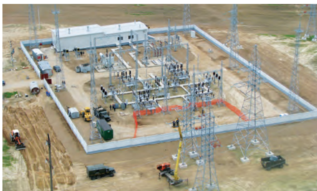
Подстанция 110/35/10 кВ «Ветропарк»
