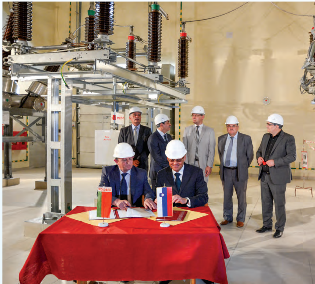
Подписание акта ввода в эксплуатацию ПС 110/10 кВ «Грушевская»
