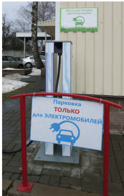
Зарядная установка для электромобилей на ул. Веры Хоружей в г. Минске
