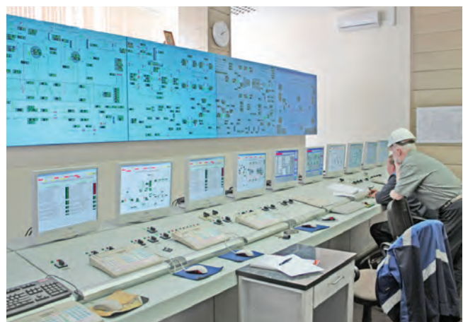
Щит управления энергоблока ПГУ 230 МВт Минской ТЭЦ-3
