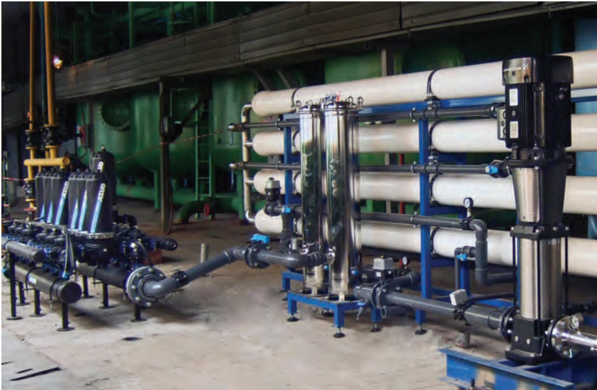
Рис. 7. Опытная нанофильтрационная установка
