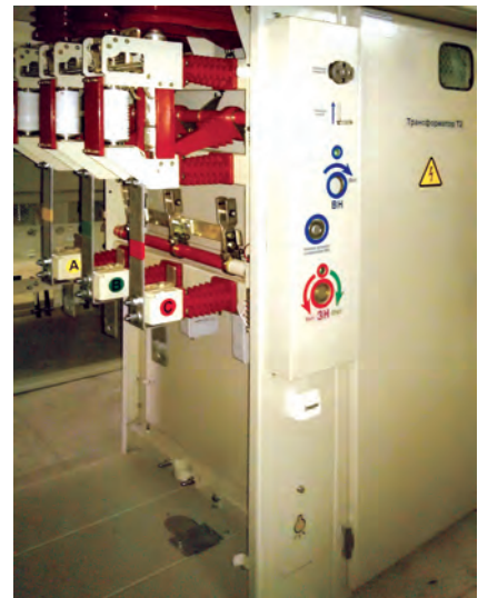
Рис. 3. Камера сборная одностороннего обслуживания 10 кВ
