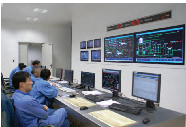
Щит управления ПГУ 400 МВт на Минской ТЭЦ-5
