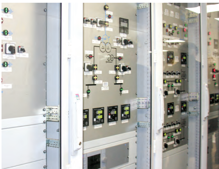
Современные шкафы управления и измерений на подстанции
