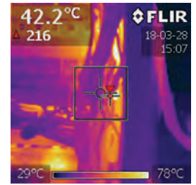
Рис. 3. Теплограмма отходящих кабельных линий в РЩ
