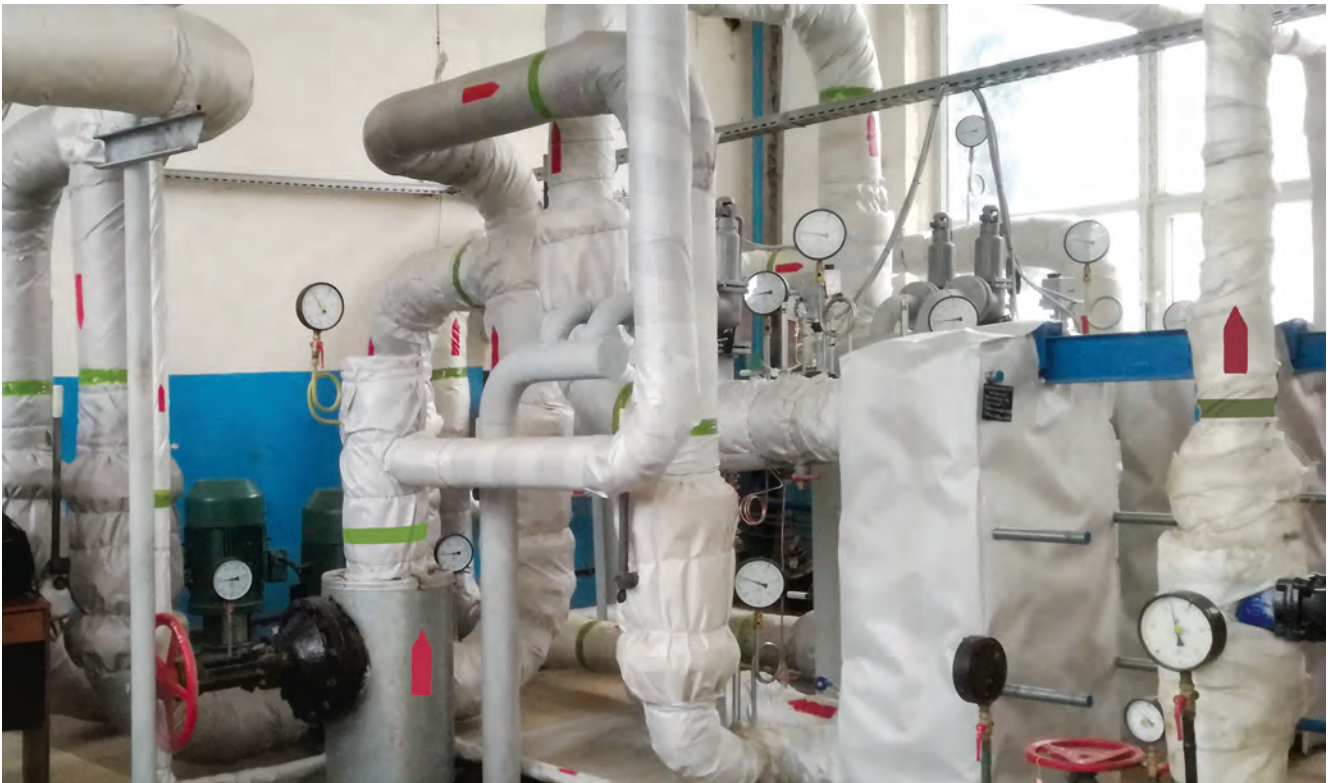
Центральный тепловой пункт
