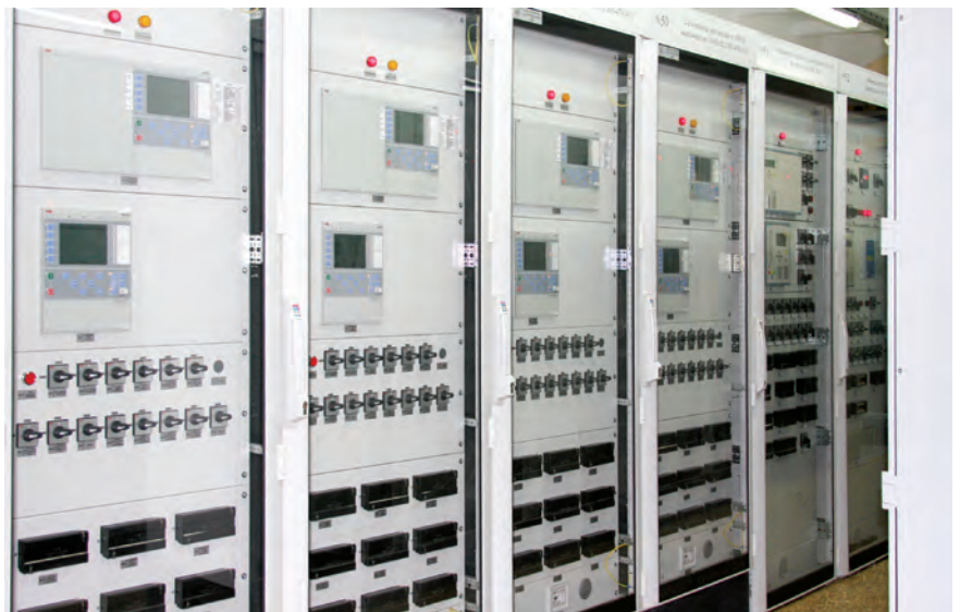
Шкафы релейной защиты и автоматики с микропроцессорными устройствами РЗА на ПС 330 кВ «Поставы»
