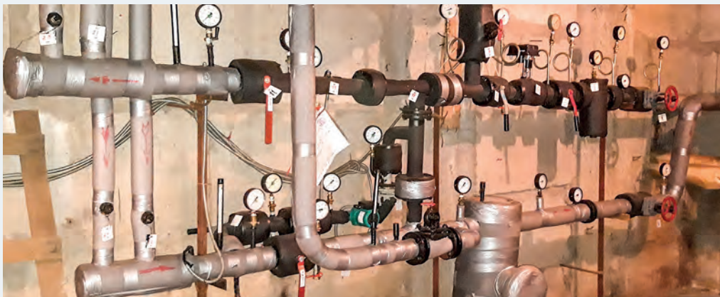
Избыточное число манометров, установленных в ТП медучреждения
