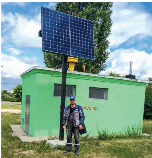
Фотоэлектрические модули, установленные на ГРП-2
