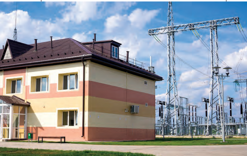
Подстанция 330 кВ «Минск-Северная»
