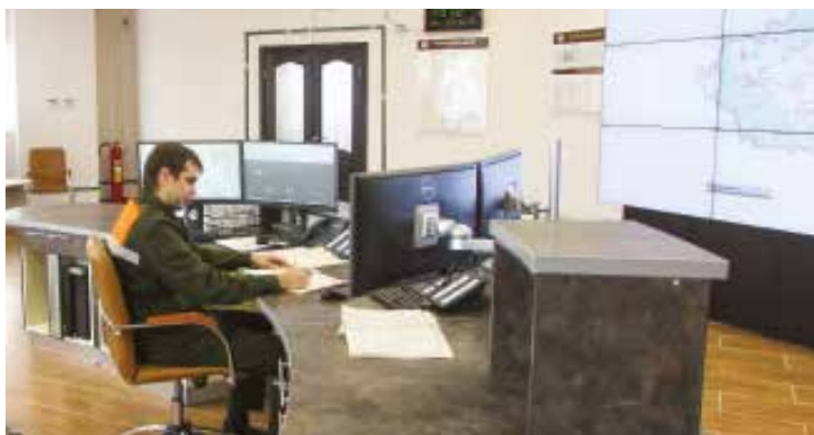
Диспетчерский щит управления Кировского РЭС
