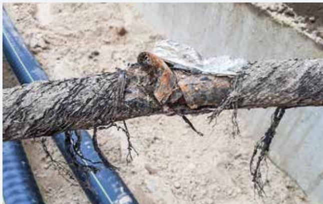
Механическое повреждение кабельной линии при производстве земляных работ
