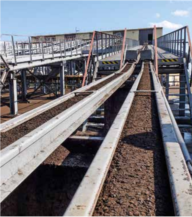
Линии подачи фрезерного торфа в котельную филиала «Торфобрикетный завод «Сергеевичское» УП «МИНГАЗ»
