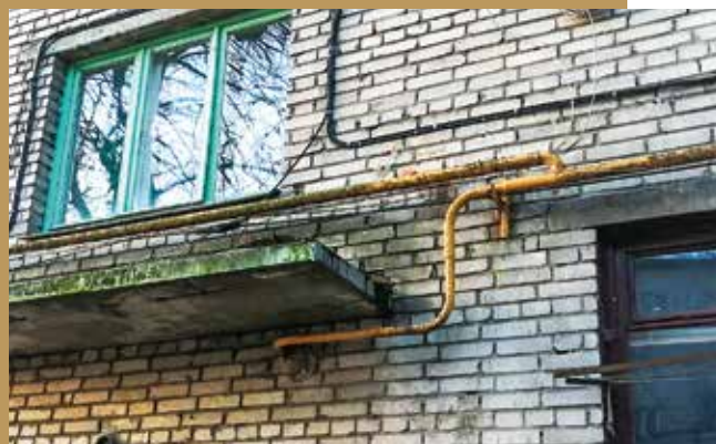
Рис. 1. Недопустимый уровень коррозии газопровода
