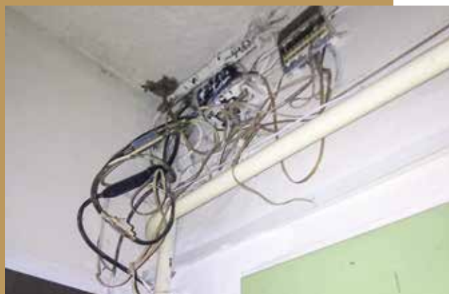
Рис. 2. Использование газопровода в качестве опоры для проводов и кабелей
