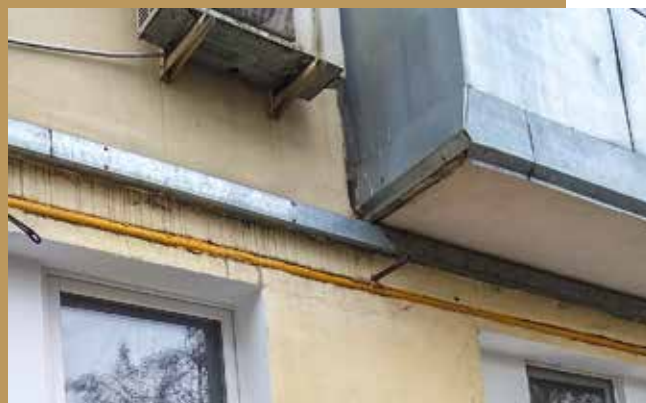
Рис. 3. Отсутствие зазора между газопроводом и элементом конструкции после тепловой реабилитации
