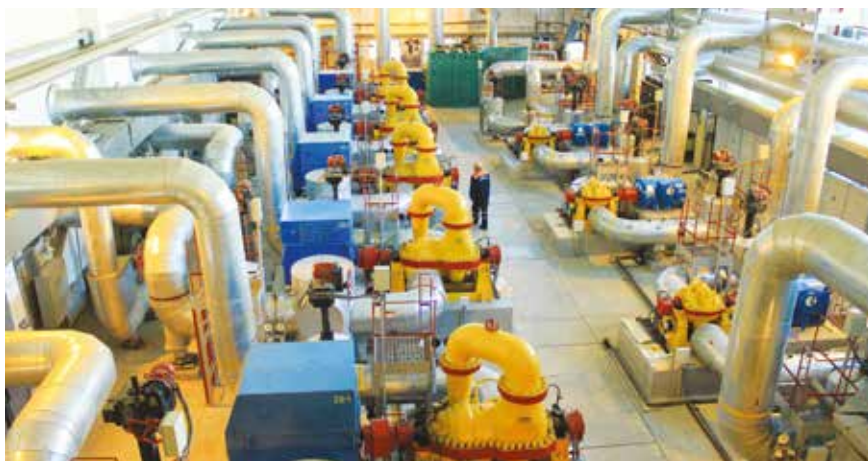
Сетевая насосная станция Центрального района тепловых сетей филиала «Гомельские тепловые сети» РУП «Гомельэнерго»
