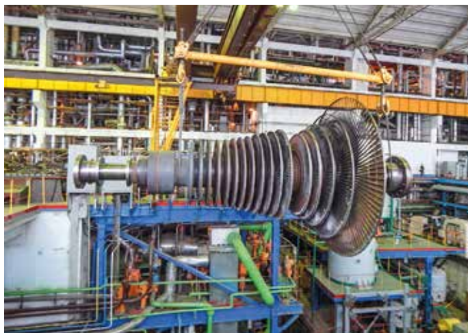
Ротор среднего давления энергоблока №3 Лукомльской ГРЭС
