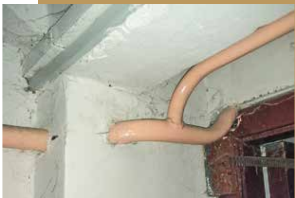
Рис. 4. Отсутствие футляра на газопроводе при пересечении им строительных конструкций
