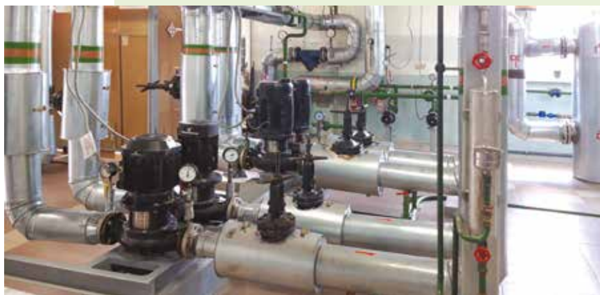
Насосное оборудование котельной Гомельских областных теплосетей
