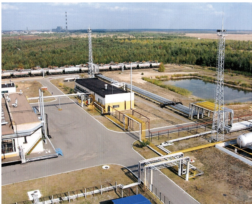
Руденская газонаполнительная станция УП «Минскоблгаз»
