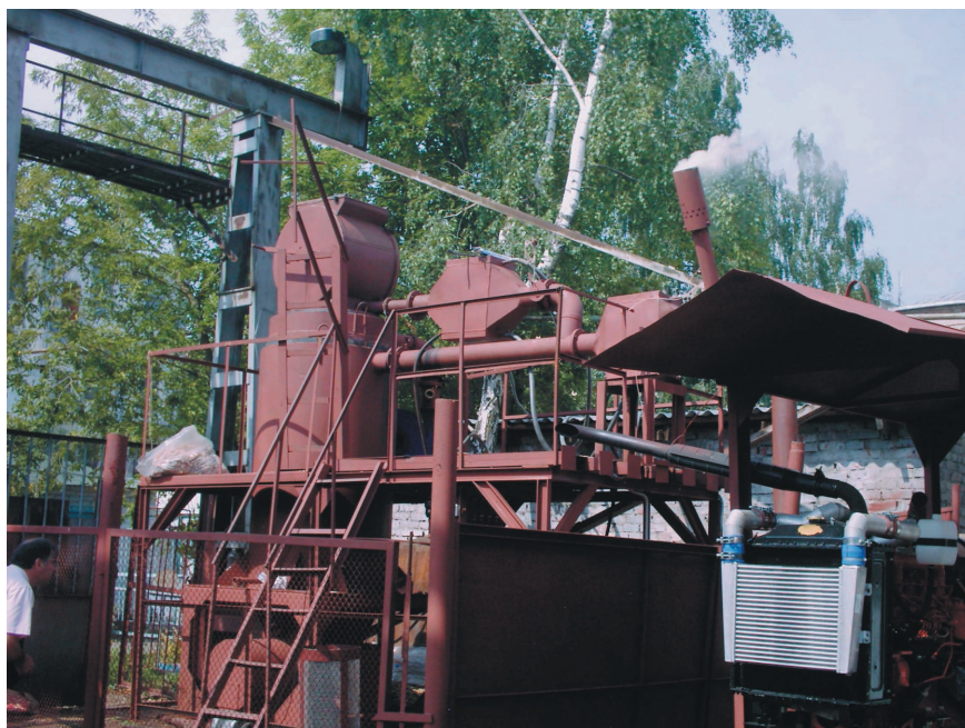
Газогенератор обратного горения (1 МВт тепловой мощности), работающий в сверхадиабатическом режиме фильтрационной газификации, разработанный в ГНУ ИТМО НАН Беларуси
