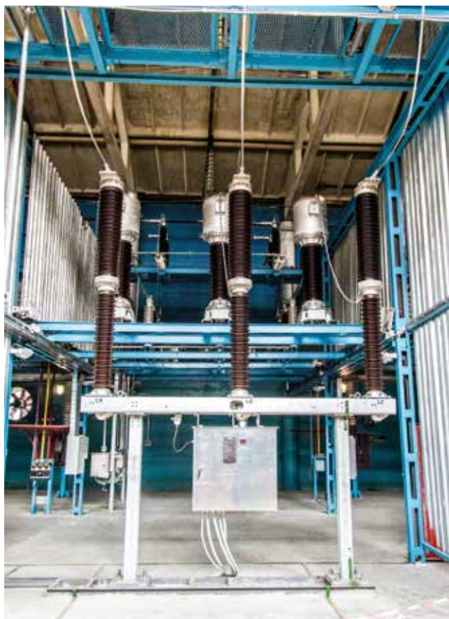
Рис. 5. Оборудование ячейки № 23 ЗРУ 110 кВ
