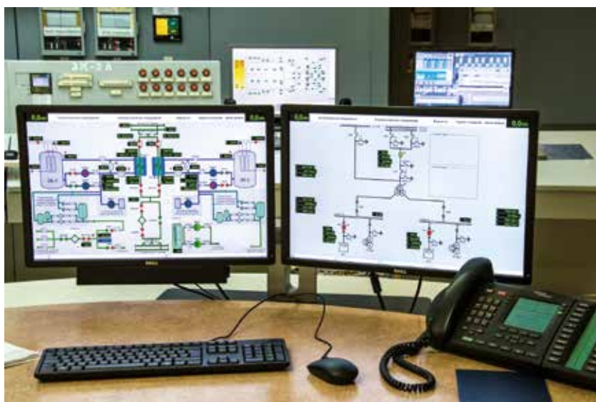
Рис. 7. АРМ управления электродкотлами ZVP-2840 на БЩУ-2
