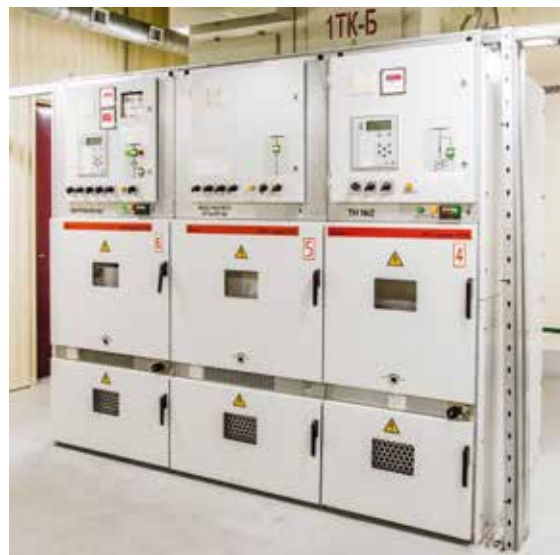
Рис. 4. РУ 10 кВ электродкотлов
