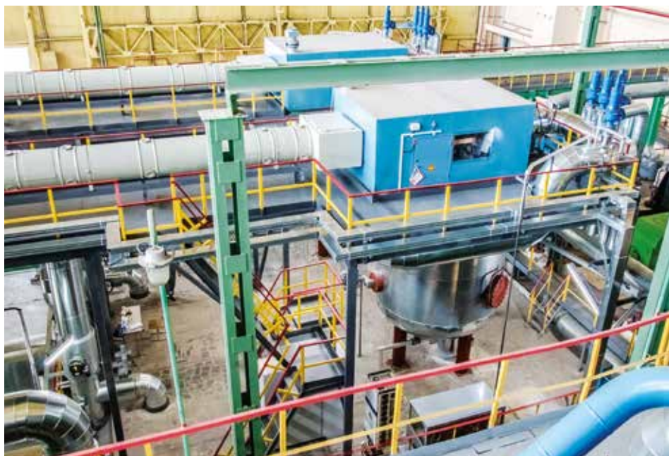
Рис. 2. Электрические водогрейные котлы типа ZVP-2840 в здании машинного зала главного корпуса Гомельской ТЭЦ-2
