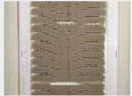
Внутренняя сторона вентиляционной решетки после года эксплуатации
