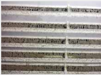
Лицевая сторона вентиляционной решетки после года эксплуатации
