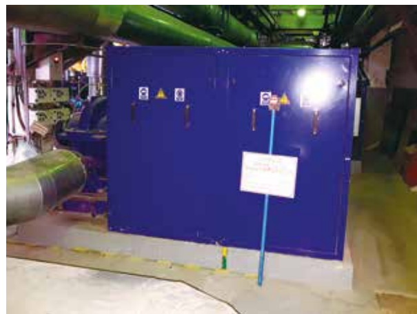
Рис. 4. Шумозащитный кожух сетевого насоса Северной мини-ТЭЦ
