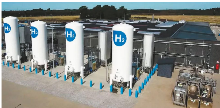
Рис. 2. Общий вид площадки для производства водородного топлива
