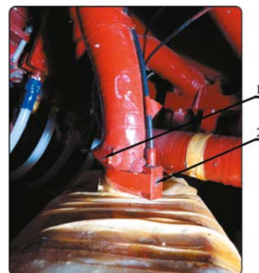
Рис. 2. Пример установки акселерометров FOA-100E (1) и FOA-200 (2) на шине генератора энергоблока № 1 Белорусской АЭС
